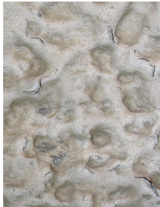
Bild 2: Spannungsrisse innerhalb der Spritzabdichtung
