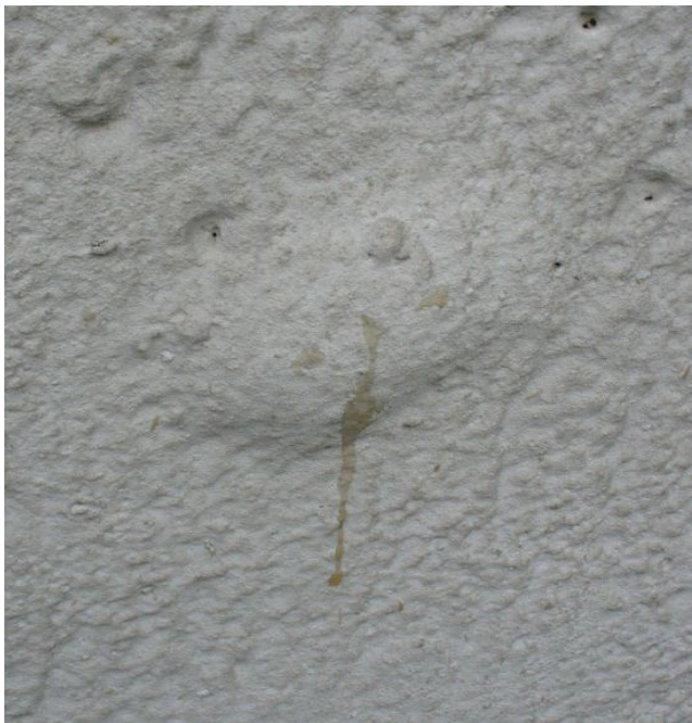
Bild 1: Blasenbildung/Örtliches Ablösen der Spritzabdichtung
