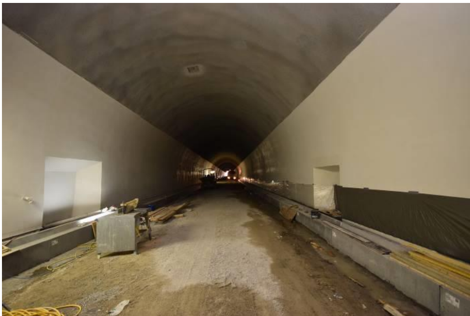
Bild 12: PCC Tunnelbeschichtung weiß
