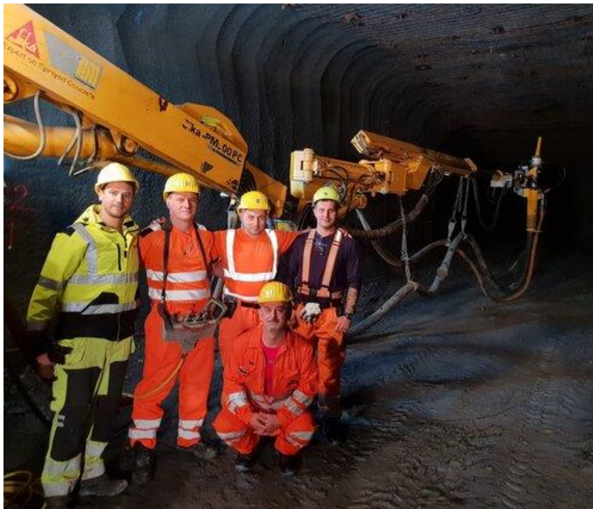
Bild 1: Erfolgreiche Teilnehmer eines EFNARC Düsenführer-Kurses nach der praktischen Baustelle-Prüfung zusammen mit ihrem zertifizierten Nozzelman Examiner. (Bild: EFNARC)
